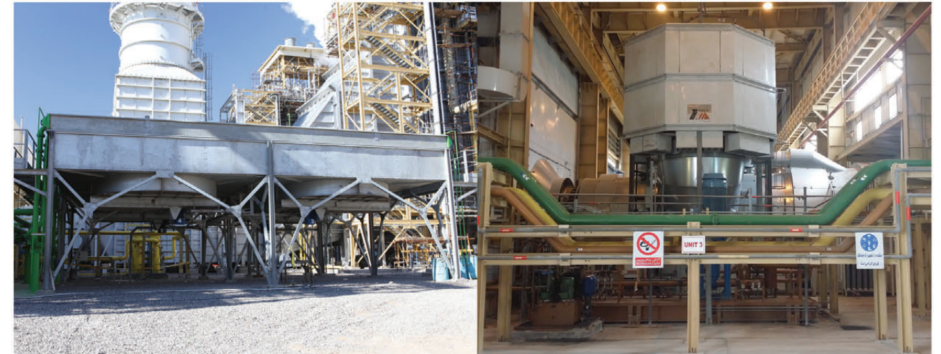
▲ سیستم خنک‌کاری کمکی (Fin Fan Cooler):
